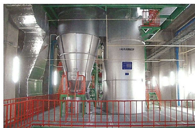
循環式流動焼却炉
