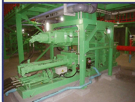
脱水ケーキ移送ポンプ
