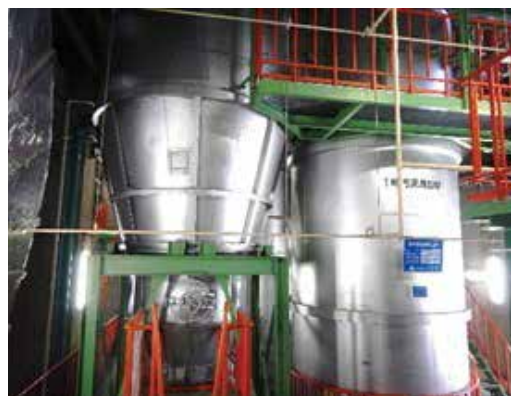
写真-24 1号焼却炉
