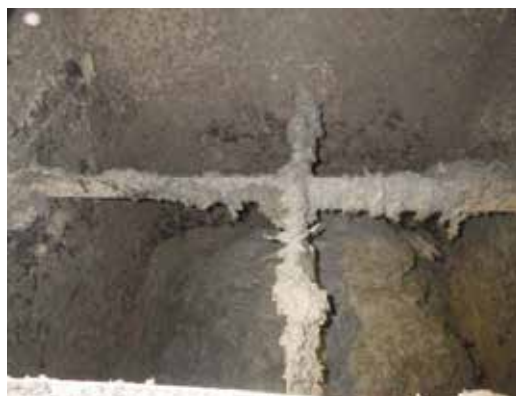
写真-23 混合物堆積状況
