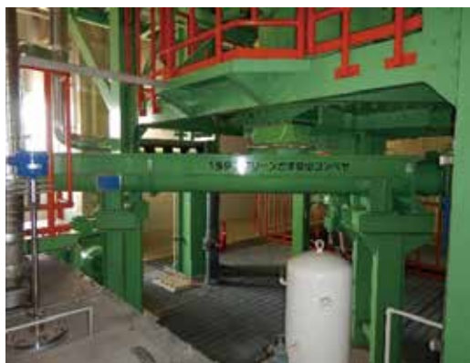
写真-19 スクリーンかす切出コンベヤ
