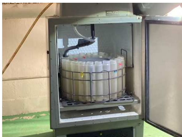
写真-2 既設オートサンプラー設置状況
