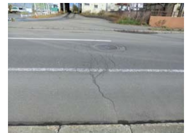
写真-2 マンホール周りの横断クラック(H27 発生)
