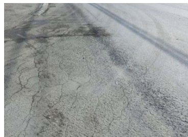
写真-1 交差点部の大型車両による面状ひびわれ(H27 発生)
