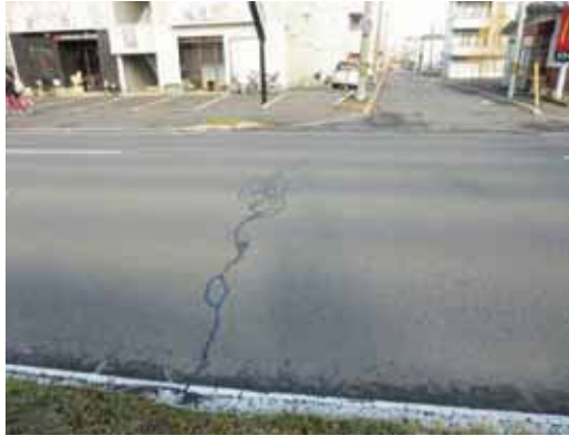
写真-3 ひび割れ③
