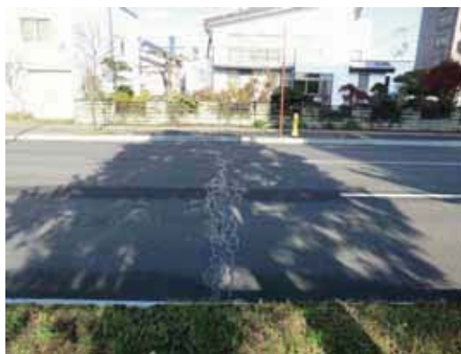
写真－10 ひび割れ③
