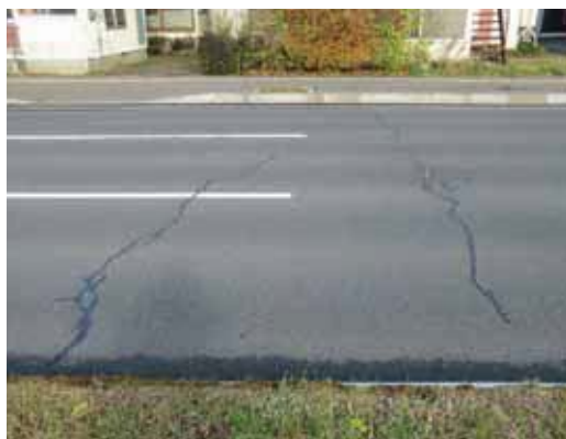
写真－8 ひび割れ①
