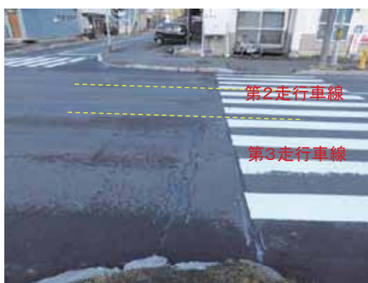
写真-1 ひび割れ①
