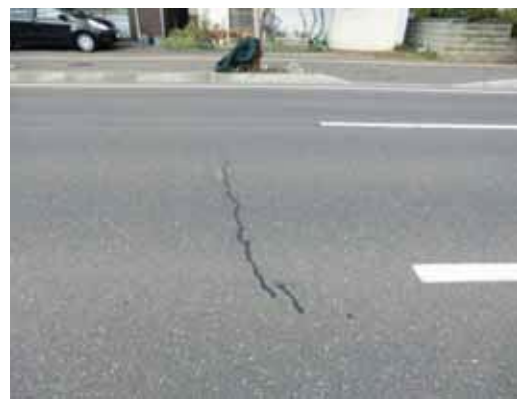
写真－9 ひび割れ②
