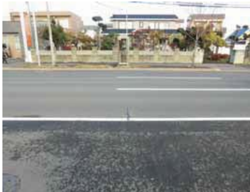
写真-7 ひび割れ⑦
