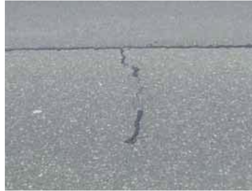
写真-4 ひび割れ④
