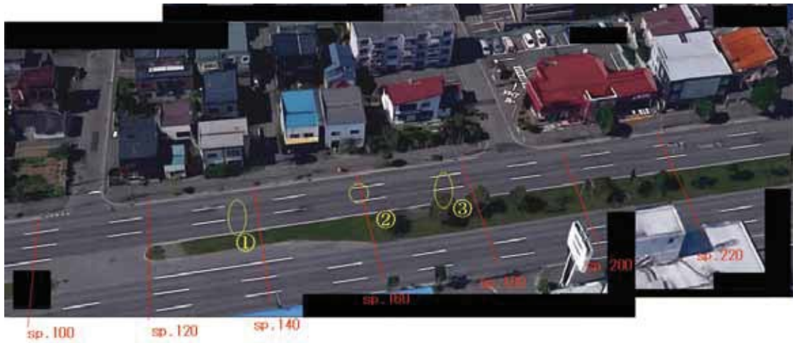
図－3 再生100%区間のひび割れ発生位置
