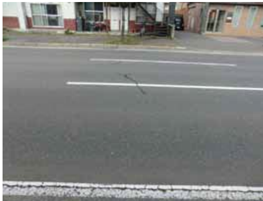
写真-5 ひび割れ⑤
