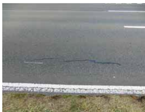
写真-11 ひび割れ①
