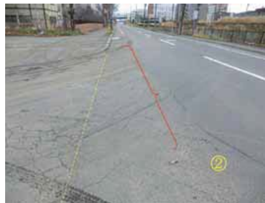
写真-2 ひび割れ②
