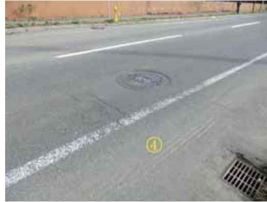
写真-4 ひび割れ④
