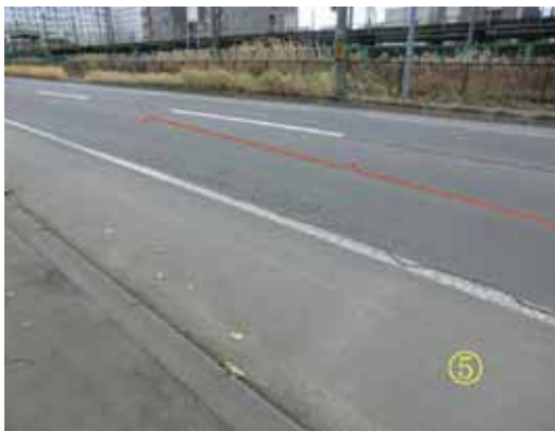
写真-5 ひび割れ⑤
