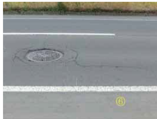
写真-6 ひび割れ⑥
