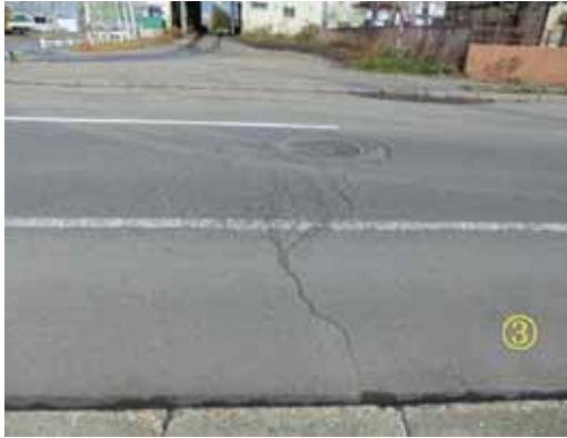
写真-3 ひび割れ③
