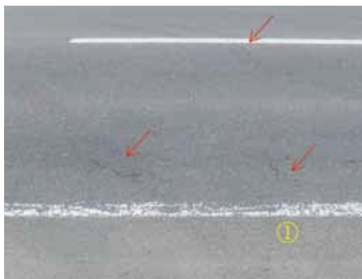
写真-1 ひび割れ①
