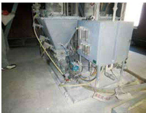
写真-1 消石灰供給ポンプ周辺
